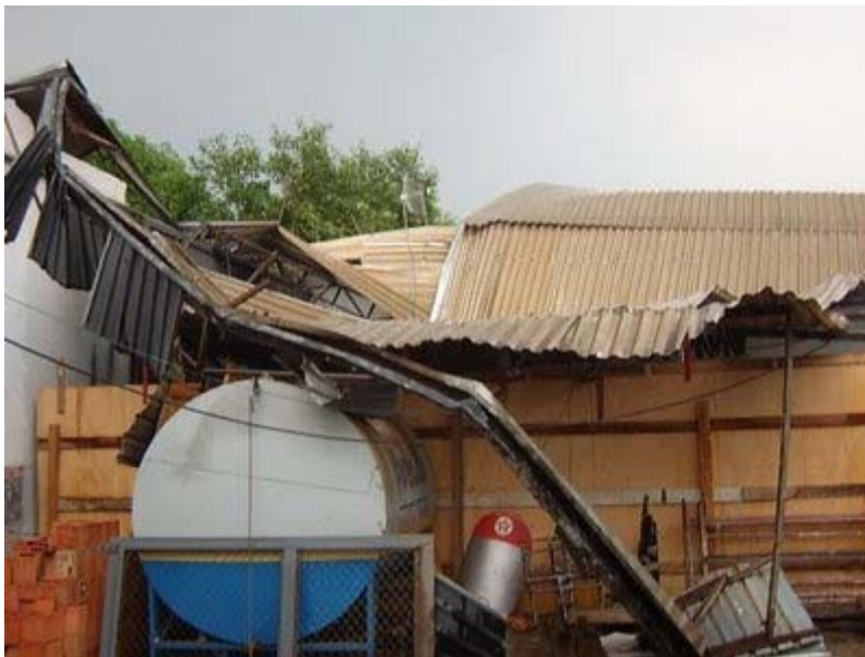
Construção tipicamente inadequada para regiões onde venta. (essa ruiu)
