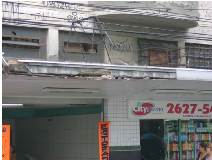
Marquise com revestimento de PVC ocultando deterioração em estado avançado. Notar a testada onde o revestimento cedeu, por não suportar o peso de material deteriorado e deslocado da marquise.
