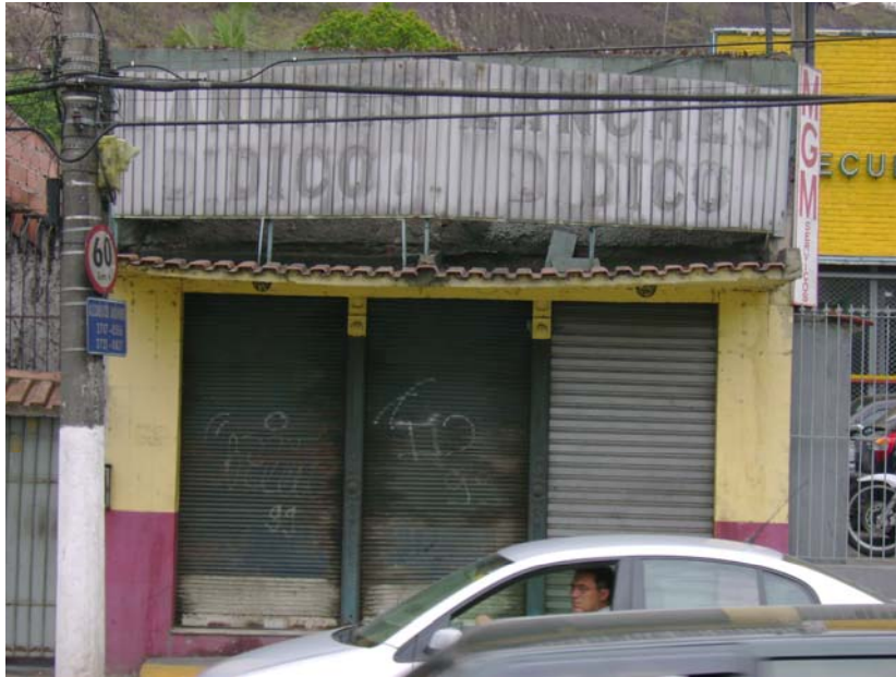
Marquise deformada pela sobrecarga de painel publicitário.
